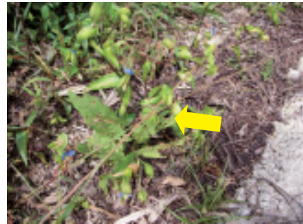
電線が草に接触している
