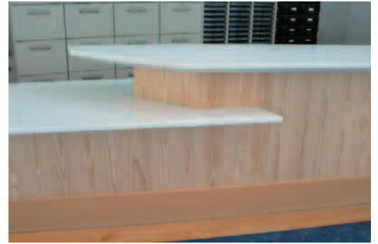
子どもや車いす使用者にも配慮したカウンター例(障害者交流プラザ)
