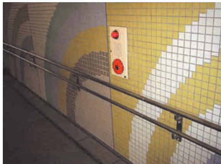
非常警報装置の一例
